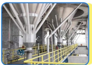
掺混料仓锥体及掺混室
