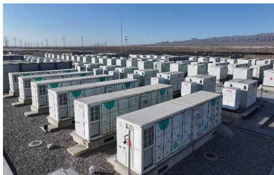
甘肃嘉峪关储能项目
