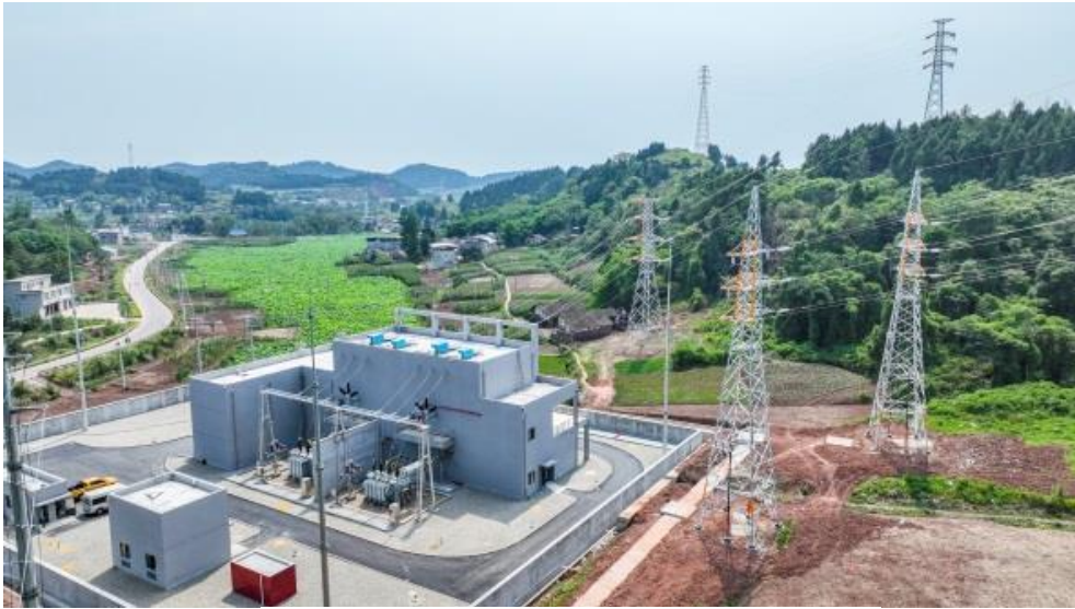
白马 110kV 输变电工程(110kV 白果变电站)
