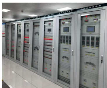
电力操作电源应用于变电站
