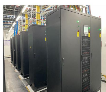
HVDC产品应用于数据中心
