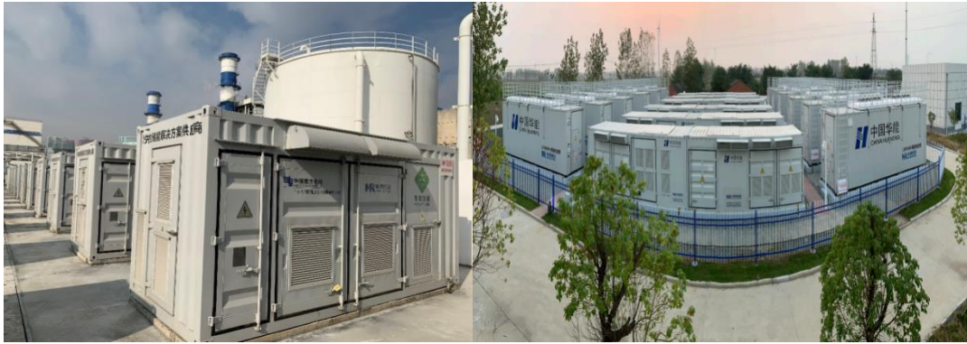
(储能工程项目现场图)
