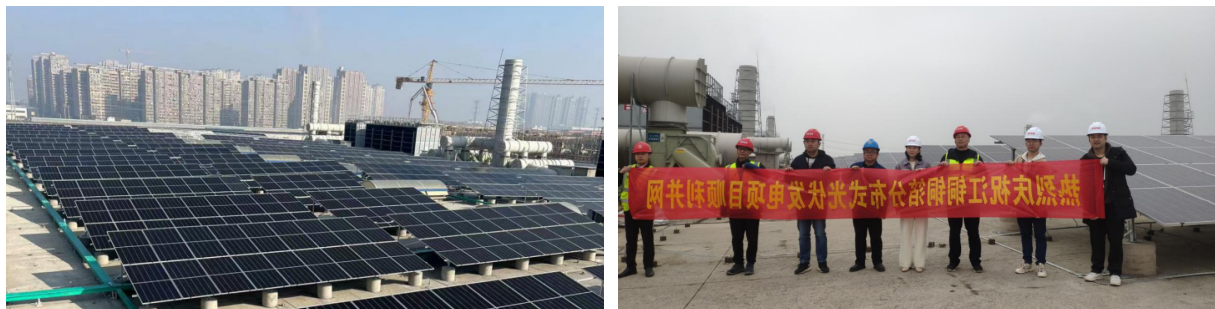
图：光伏发电项目现场图
